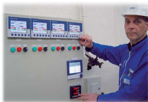
Pulpit regulacyjno-sterowniczy suszarni, służący także celom archiwizacji i sygnalizacji
